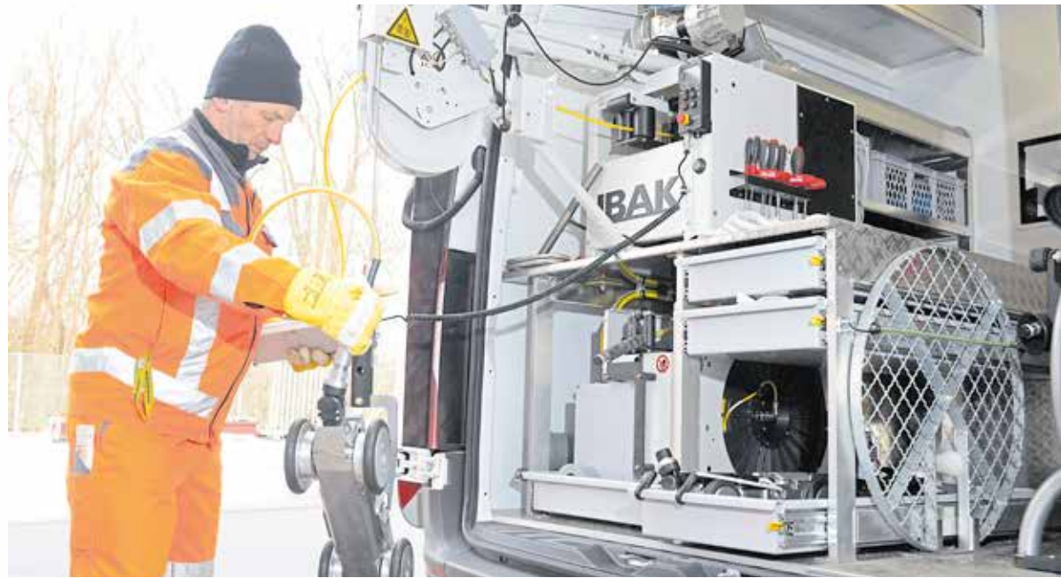
„Robotertechnik erleichtert unseren Mitarbeitern die Arbeit. Es können Bereiche untersucht werden, die man früher nicht ergründen konnte“, sagt Michael Berndt, Geschäftsführer Berndt Rohr- und Kanalservice GmbH. Foto: Thorsten Ecker/DDV Kreativ
